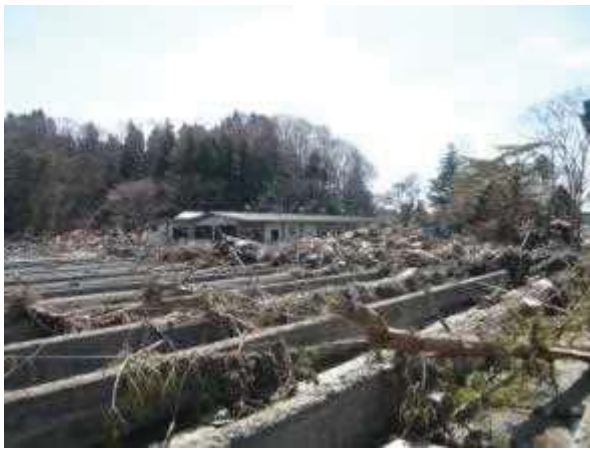
図3 被災した岩手県宮古市津軽石川ふ化場
